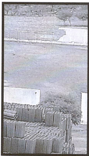
Figura 02: Abertura no muro, ocasionado pela passagem d'água Fonte: Autor (2022)
