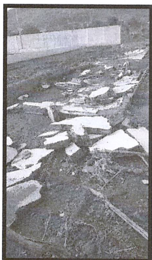
Figura 01: Muro em ruínas
